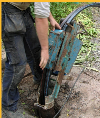
Kollektorns anslutning till energibrunn
