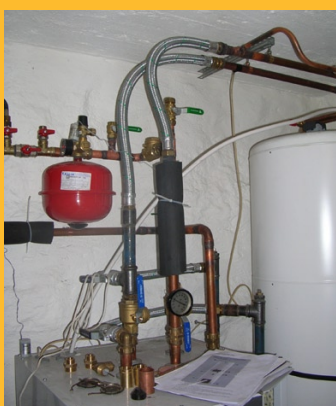
Värmepump installerad inomhus
